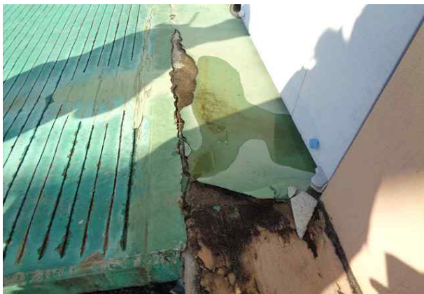
외부 출입구 마감재 파손 (A=1.5m×0.3m)
