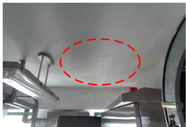
내부 천장 균열 및 누수흔적 (CW=0.2mm, L=1.5m)
