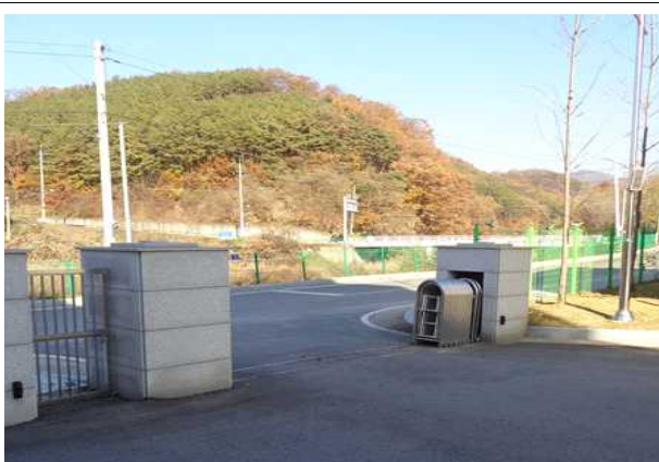
외부 주변지반 침하로 인한 바리게이트 개폐불량
