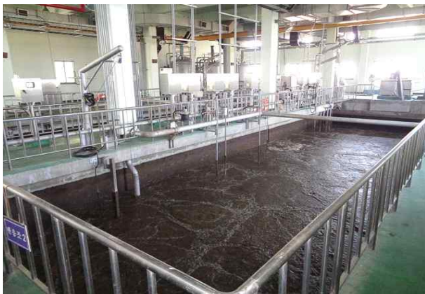
내부 1층 제1반응조 전경
