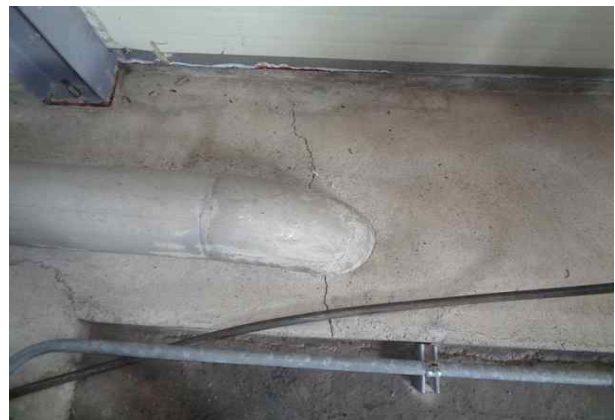
내부 총인가압부상실 바닥 균열 (CW=0.3mm, L=0.5m)
