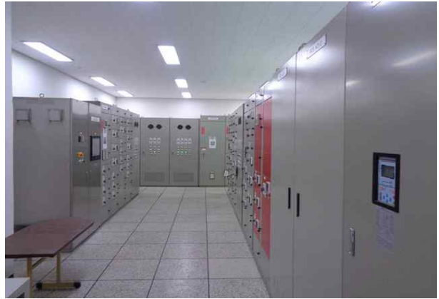
내부 전기실 전경
