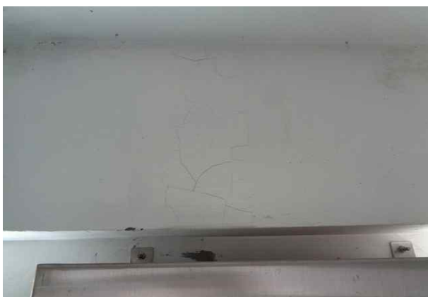
내부 벽체 마감망상균열 (A=0.2m×0.5m)
