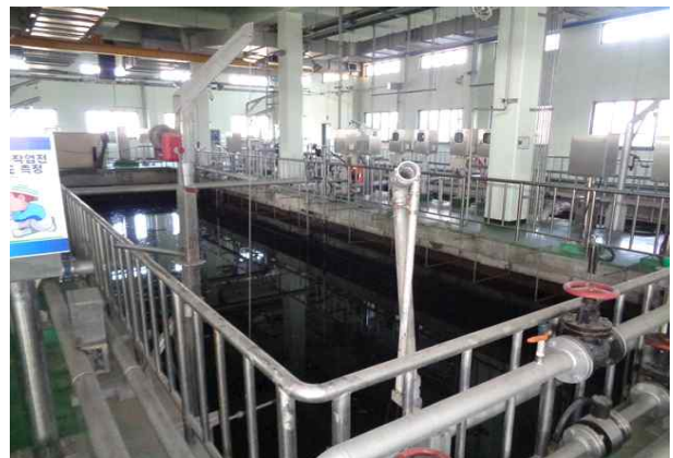
내부 1층 제2반응조 전경
