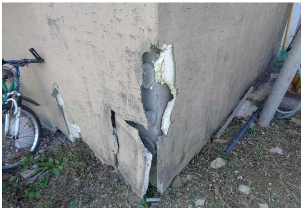
외부 벽체 마감재 파손 (A=0.5m×1.5m)
